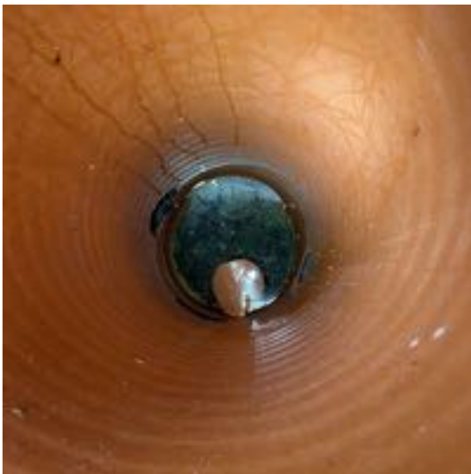
35. Salaojat tarkastettiin salaojan tarkastuskaivoista (ei havaittu padottunutta vettä). Suosittellaan salaojien kuvaamista järjestelmän todellisen toimintakunnon selvittämiseksi (säännöllinen huolto-/tarkastustoimenpide).
