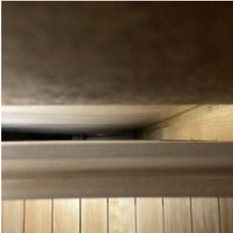
41. Yleiskuva: Saunan paneeliseinän takaa havaittiin tuuletusrako.
