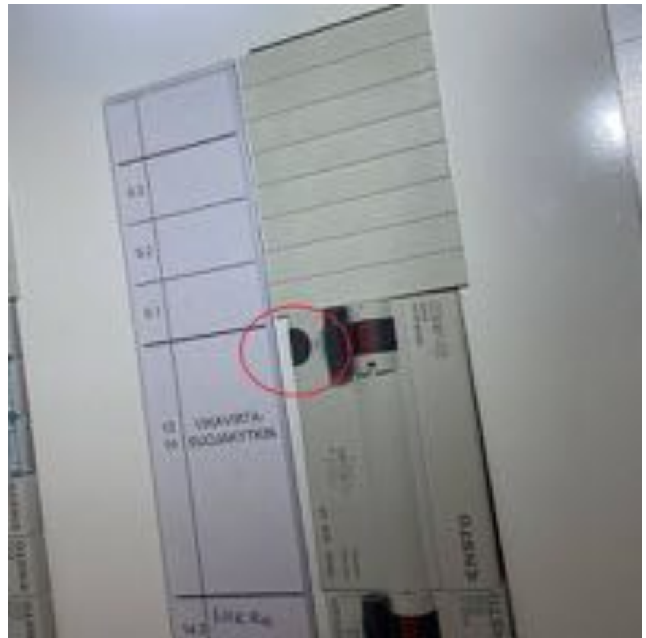
79. Yleiskuva: Asunnon vikavirtasuojakytkimien toiminta testattiin tarkastuksen aikana. Oikein toimiva suoja laukeaa testipainikkeesta ja katkaisee virran sen takana olevista piireistä ja sähköllä toimivista laitteista. Vikavirtasuojakytkimien toiminnassa ei havaittu puutteita.
