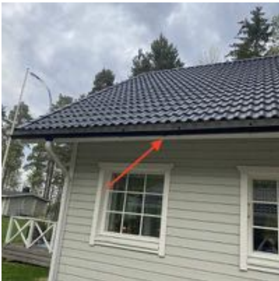
8. Huomio: Rakennuksen edessä havaittiin vesikourun olevan hieman taipunut. Mikäli kourun toiminnassa (riittävässä vedenpoistossa) havaitaan puutteita, suositellaan kourun suoristamista vääntyneeltä osin.
