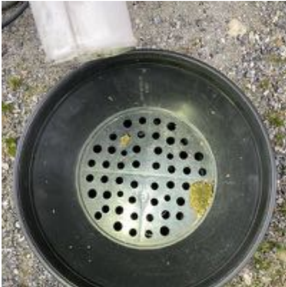
37. Yleiskuva: Sadevedet johdetaan sadevesijärjestelmään rakennuksen nurkilla. Suositellaan loiskevesikaivojen säännöllistä puhdistamista (esimerkiksi lehtien poistaminen). Hallitsemattomat hulevedet aiheuttavat rakenteiden kosteusrasitusta.
