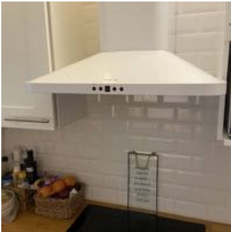
64. Yleiskuva: Keittiön liesituuletin toimii erillisenä kohdepoistona. Suodattimet ovat puhtaat. Liesituulettimen rasvasuodattimet tulee pitää puhtaana säännöllisellä huollolla paloturvallisuuden varmistamiseksi.
