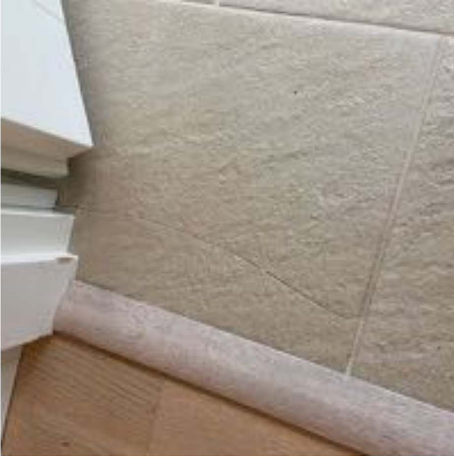
81. Huomio: Eteisen lattialaatasta havaittiin halkeama. Halkeamat lattialaatoissa voivat aiheuttaa käyttöturvallisuusriskin (viiltovaara).
