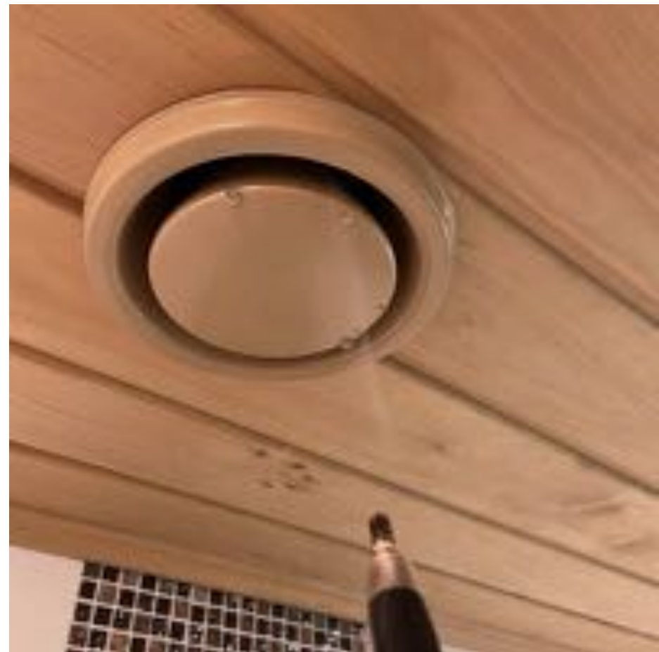
61. Yleiskuva: Ilmanvaihtojärjestelmän poistokanavien ilmavirtausta testattiin merkkisavulla pistokoelutoisesti. Ilmavirtaussuunnissa ei havaittu puutteita. Testi suoritettiin pesuhuoneessa.
