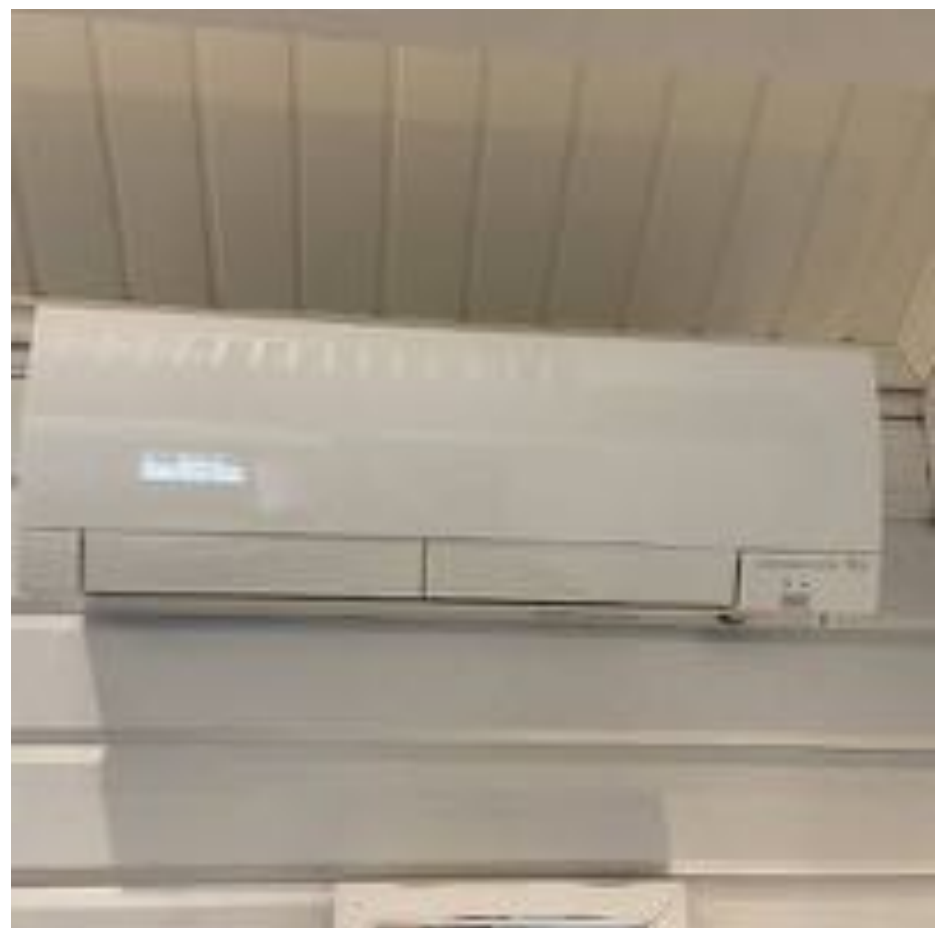
52. Yleiskuva ilmalämpöpumpun sisäyksiköstä. Sisäyksikön asennuksessa ei havaittu puutteita.
