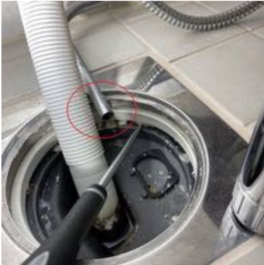
62. Yleiskuva: Ilmanvaihtokoneen kondenssivedet on viemäroity nykyohjeiden mukaisesti.
