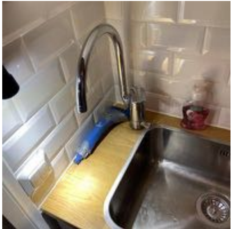
69. Kodinhoituhuoneen vesihanan juoksuputki kääntyy pöytäpinnan päälle (rajoittimen säätö puutteellinen). Riskinä on veden valuminen altaan ulkopuolelle (vesivahinkoriski). Suositellaan vesihanan juoksuputken kääntymiskulman rajoittimen säätämistä.
