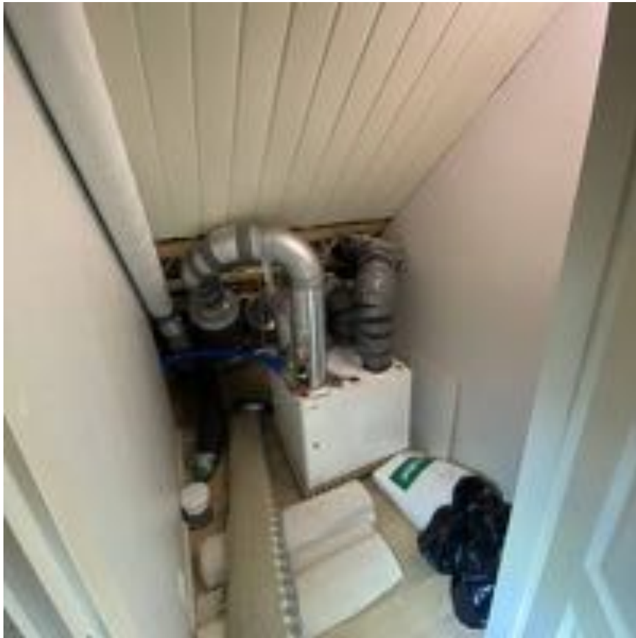
89. Yleiskuva yläkerran teknisestä tilasta.
