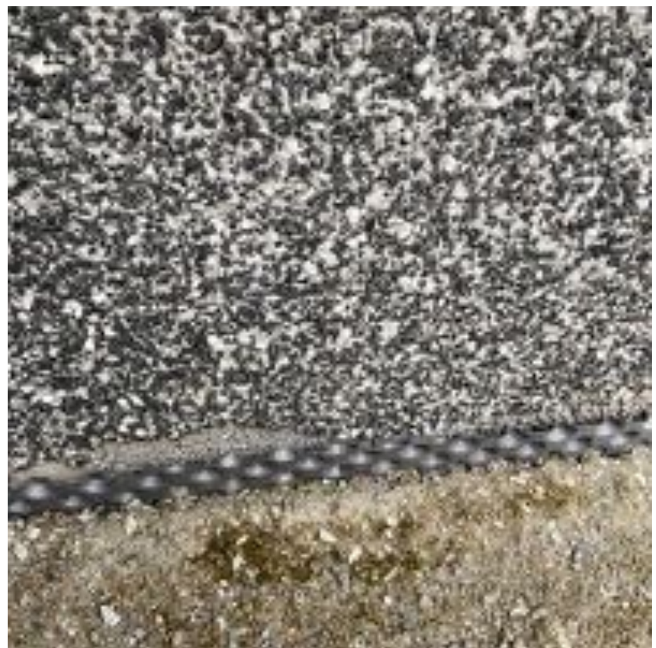
36. Patolevyn yläreunan peitelista puuttuu osassa patolevyä. Peitelista estää orgaanisen aineen pääsyn sokkelin ja patolevyn väliin. Suosittellaan patolevyn peitelistan asentamista puuttuvilta osin.
