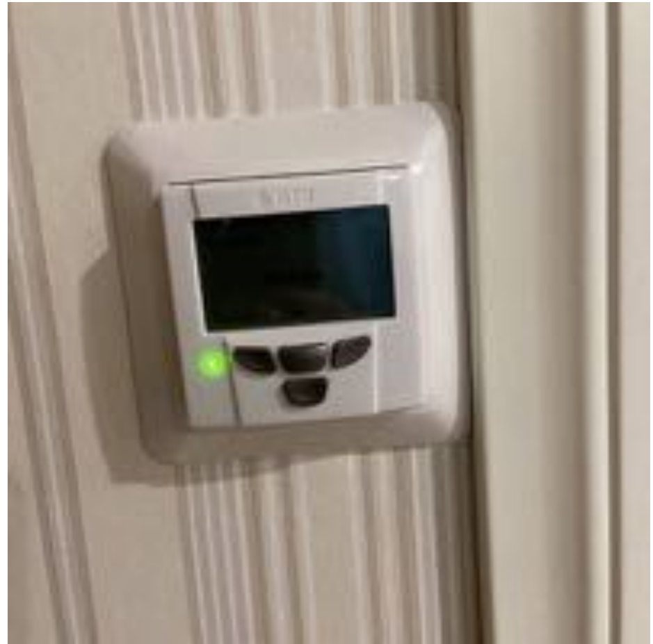
63. Yleiskuva: Ilmanvaihdon säätö tapahtuu eteisen seinällä sijaitsevasta käyttöpaneelistä. Ilmanvaihdon oikean käytön varmistamiseksi asukkaan tulee tutustua valmistajan ohjeisiin.
