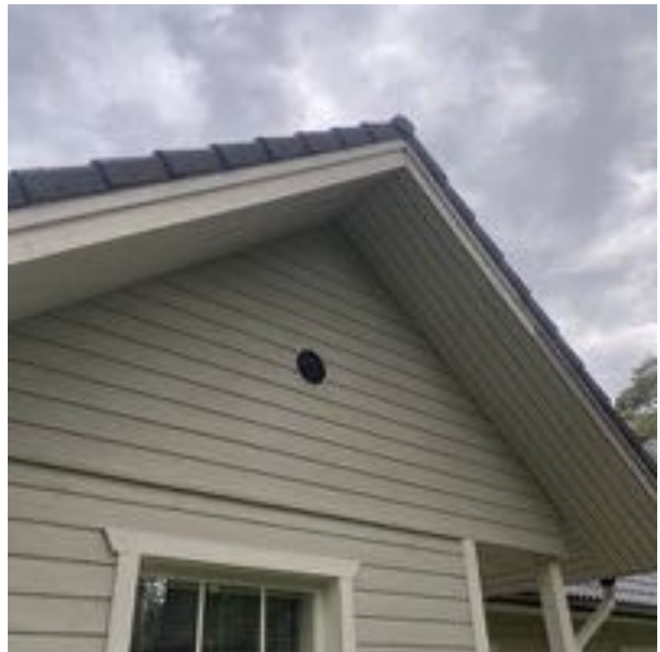
65. Yleiskuva: Ulkoilmakanava sijaitsee suunnitelmien mukaisella paikalla rakennuksen päädystä. Suositellaan puhdistamaan ulkoilmakanava ja säleikkö aina tarvittaessa.
