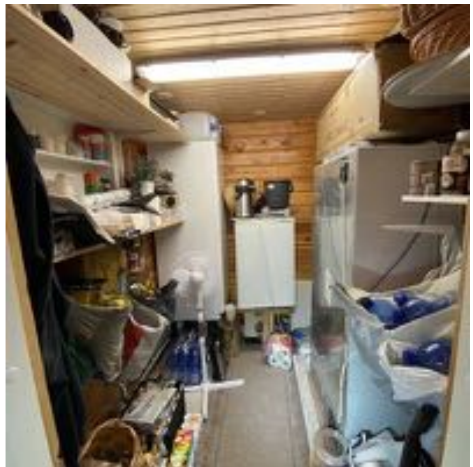
88. Yleiskuva alakerran teknisestä tilasta.
