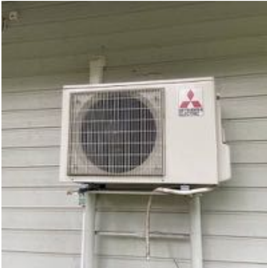
53. Yleiskuva ilmalämpöpumpun ulkoyksiköstä. Ulkoyksikön asennuksessa ei havaittu puutteita.
