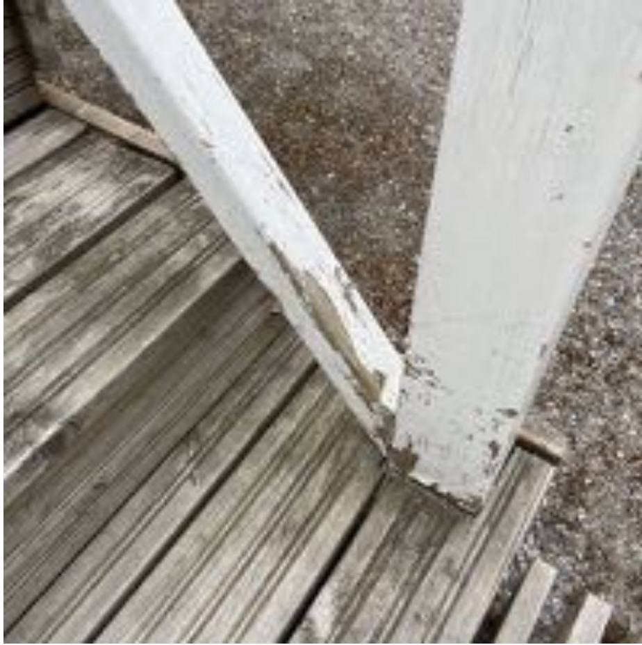
25. Myös ulkokuistin kaiteiden maalipinnassa on kulumisen merkkejä. Puuosien huoltomaalaukseen tulee varautua niiden kestävyuden varmistamiseksi.
