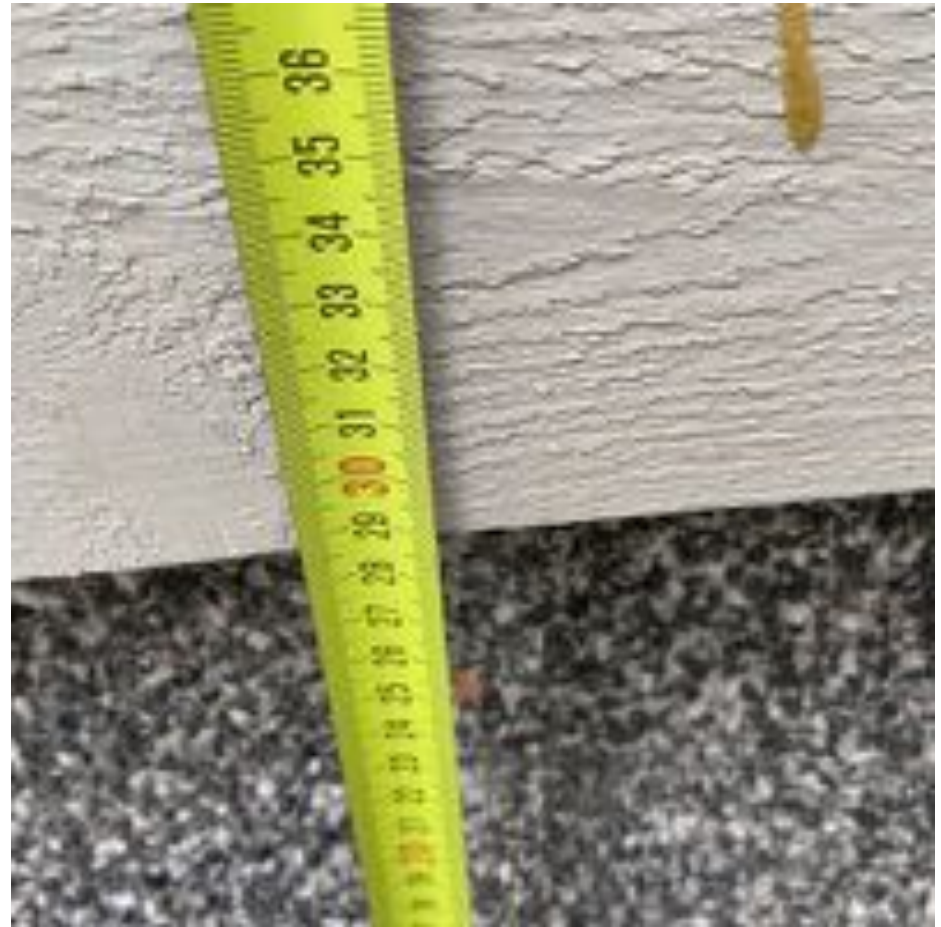
38. Yleiskuva: Sokkelin korkeudeksi mitattiin 285 mm. Sokkelin suosituskorkeus on >300 mm rakenteiden kosteusrasituksen minimoimiseksi (kinostuva lumi, roiskevesi, kapillaarinen kosteus).
