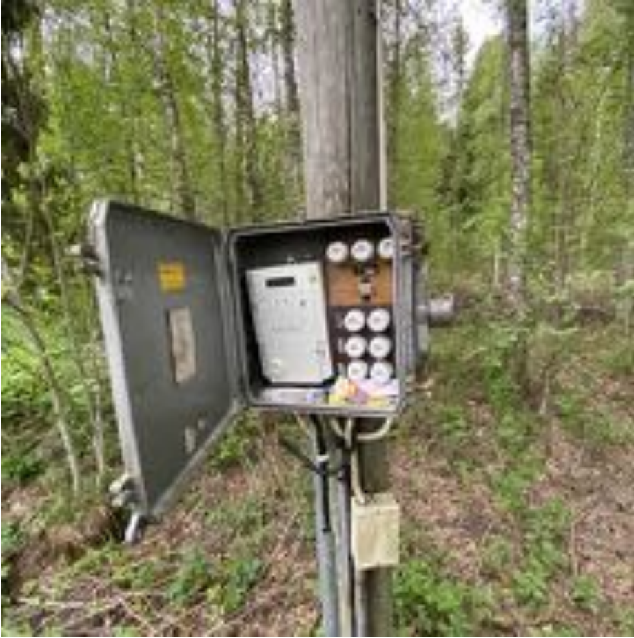
76. Yleiskuva tonttikeskuksesta/ mittarikeskuksesta.
