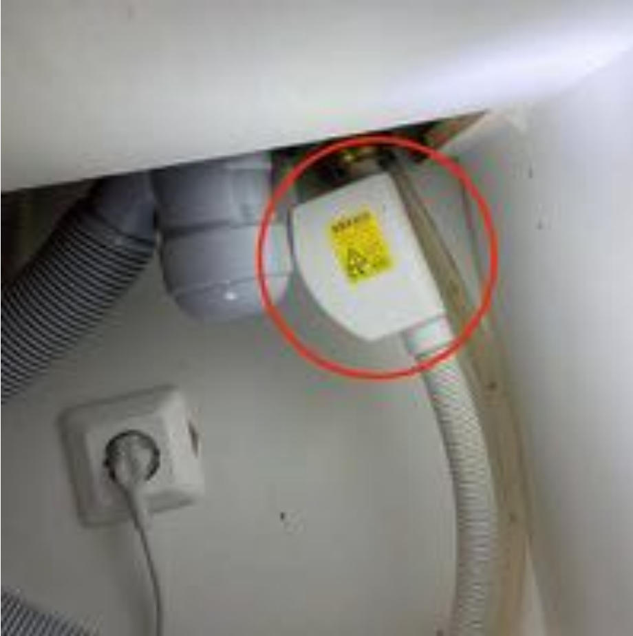
66. Astianpesukoneen vesijohdon kannakointi on puutteellinen (ei ole kiinnitetty seinään). Suositellaan astianpesukoneen vesijohdon kannakoinnin parantamista vesivahinkojen välttämiseksi.
