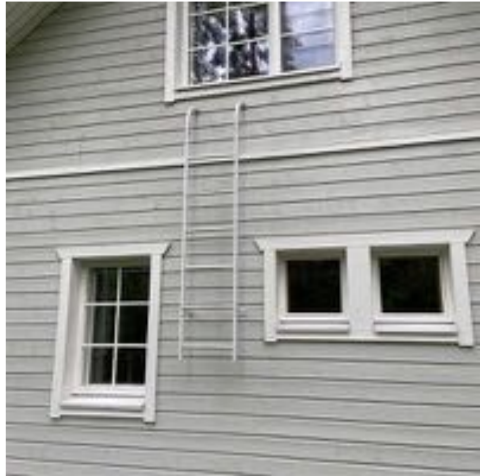
30. Yleiskuva: Yläkerran makuuhuoneista on järjestetty hätäpoistumistiet. Pudottautumiskorkeuden ollessa yli 3,5 m tulee yläkerrasta järjestää hätäpoistumistikkaat.
