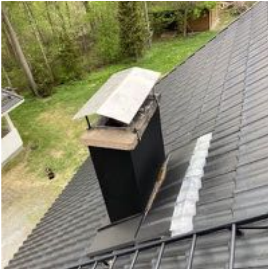
10. Yleiskuva: Hormien päälle on asennettu sääsuojat (hattupelti). Sääsuoja estää lumen ja veden pääsyä hormiin.
