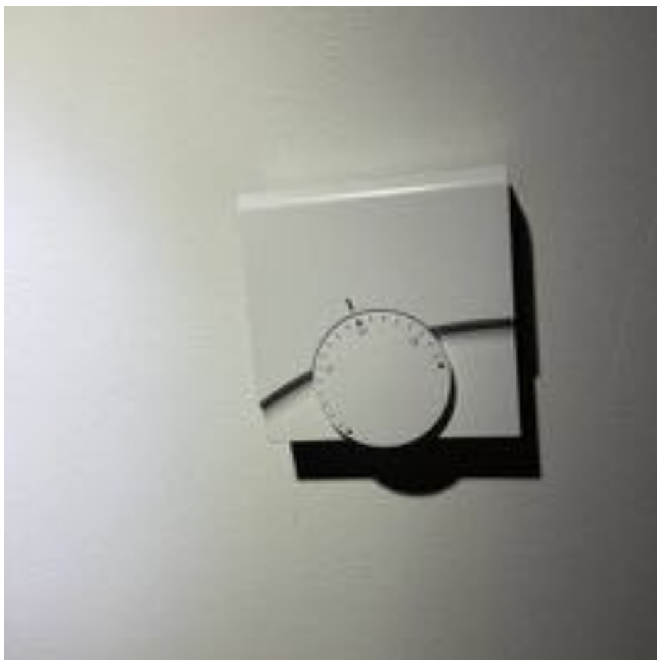
51. Yleiskuva: Rakennuksen lattialämmitystä säädetään huone-/tilakohtaisista termostaateista.
