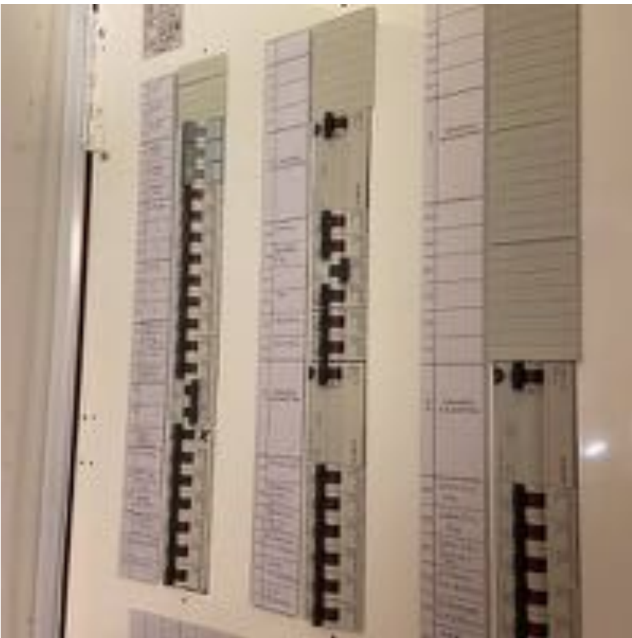
78. Yleiskuva: Sähkökeskuksen nimikyltit ovat selkeät ja helposti luettavissa.
