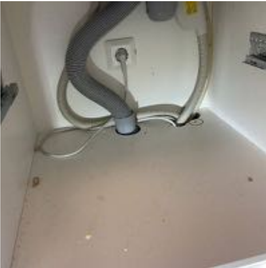
68. Keittiön allaskaapin mahdollisia vuotovesiä ei johdeta hallitusti näkyville. Suositellaan keittiön allaskaapin tiivistämistä tai vuotohälyttimen asentamista allaskaapin alle/lattialle mahdollisten vuotovesien havaitsemiseksi.
