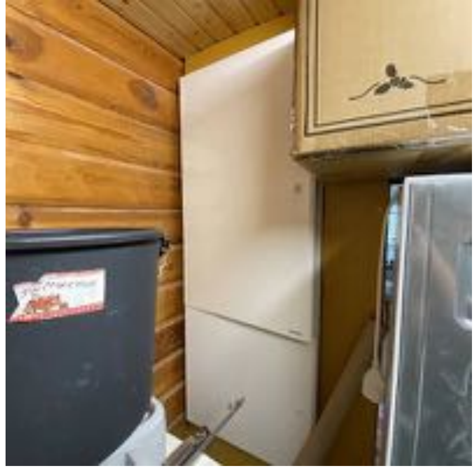
77. Yleiskuva: Ryhmäkeskus on suojattu määräysten mukaisesti.
